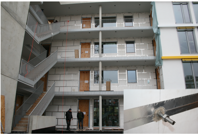
Montierte Fläche in München, Ackermannbogen (Architekt Werle)
